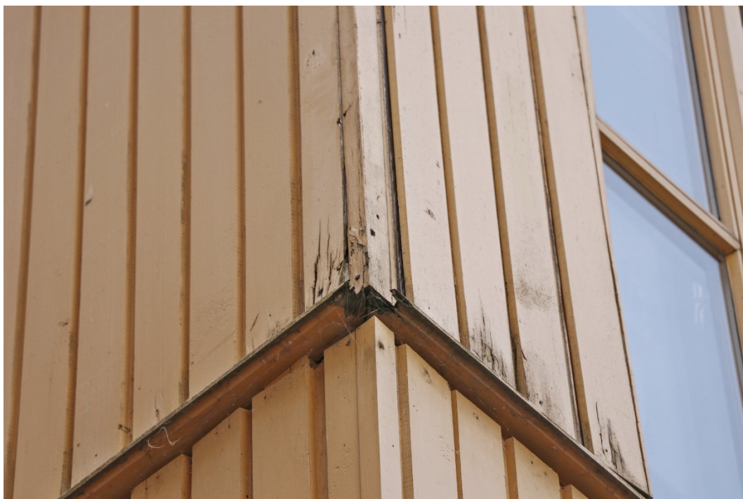
6. Degradace dřevěného obkladu v horní části výtahové šachty v místě kumulace vody na kordónové římsě.
