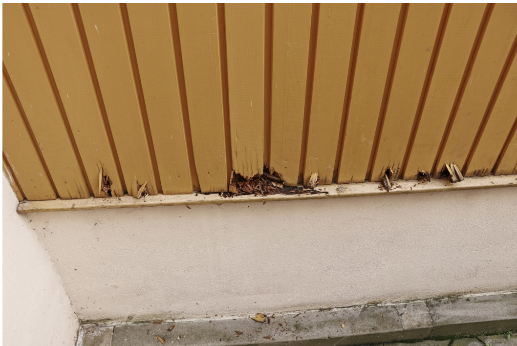
7. Degradace spodní části obkladu trámovkou a ligninová dřevokazná houba
