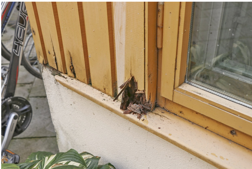
5. Degradace spodní části obkladu dřevokaznou houbou trámovkou
