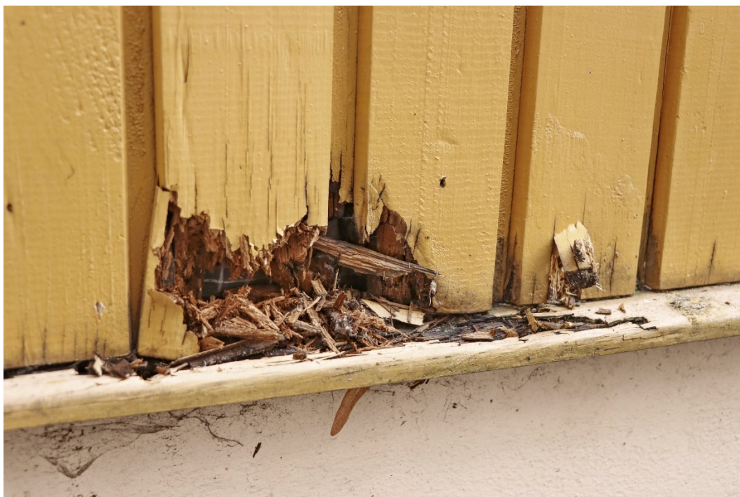
8. Detail poškození dřeva z předchozího snímku
