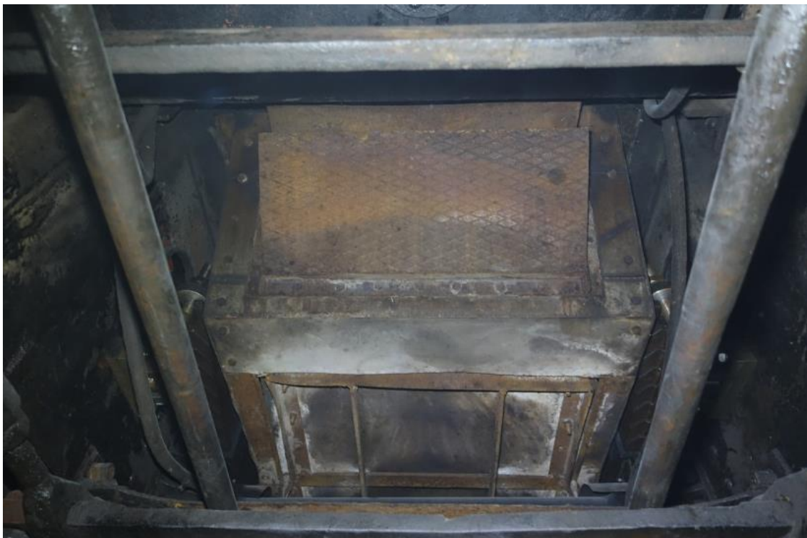
Obr. 7.3. - 4 Přední klapka popelníku (z rýhovaného plechu) byla vytvořena dodatečně kvůli spolehlivému chlazení roštnic pod trubkovnicí. Ovládá se z ochozu pomocí řetízku.
