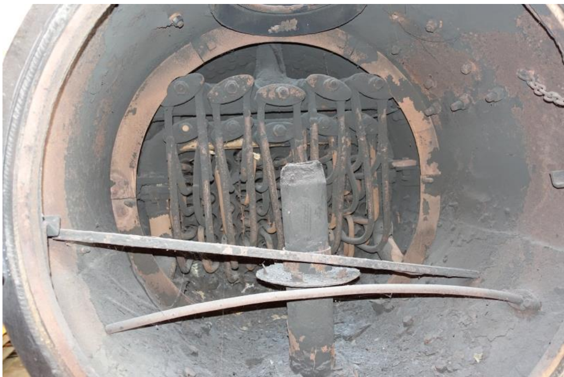
Obr. 7.3. - 7 V dýmnici chybí protipožární síta a deflektor. Kruhový nosič síta je ve spodní části rozpadlý.
