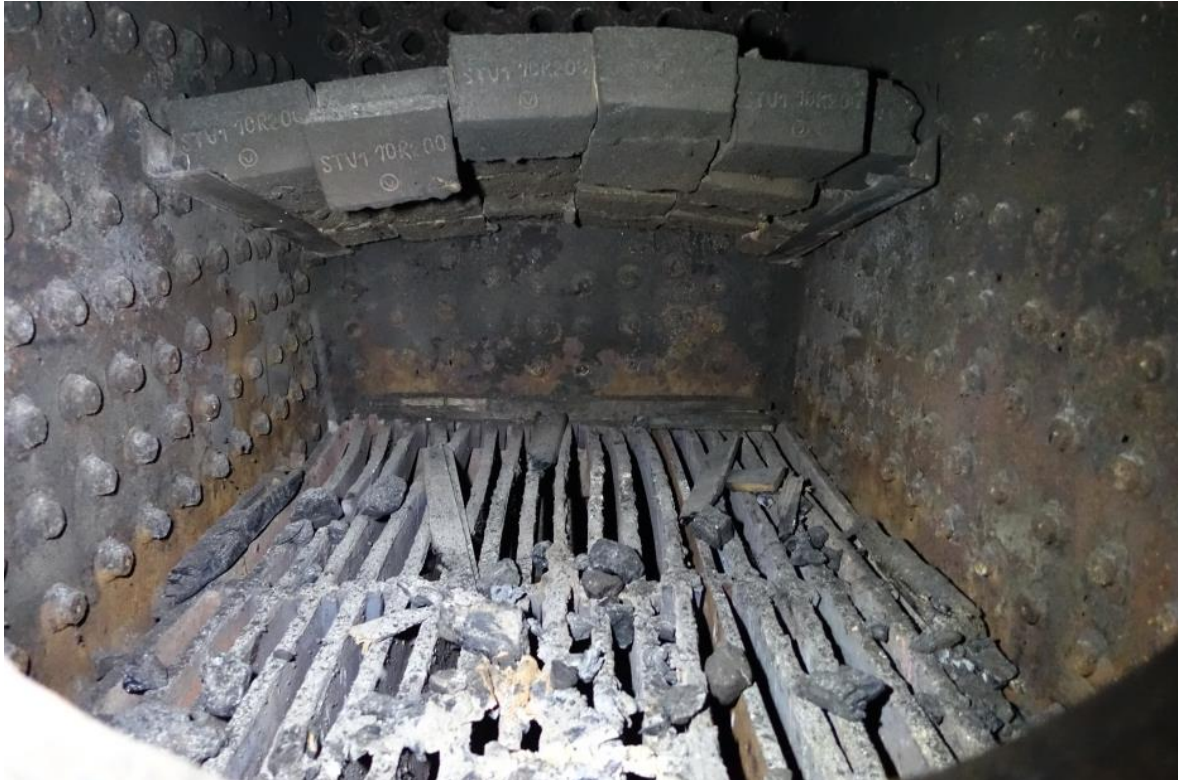
Obr. 7.3. - 1 Rošt je provozně opotřebený, roštnice se odlijí kompletně nové s druhou sadou do rezervy.
