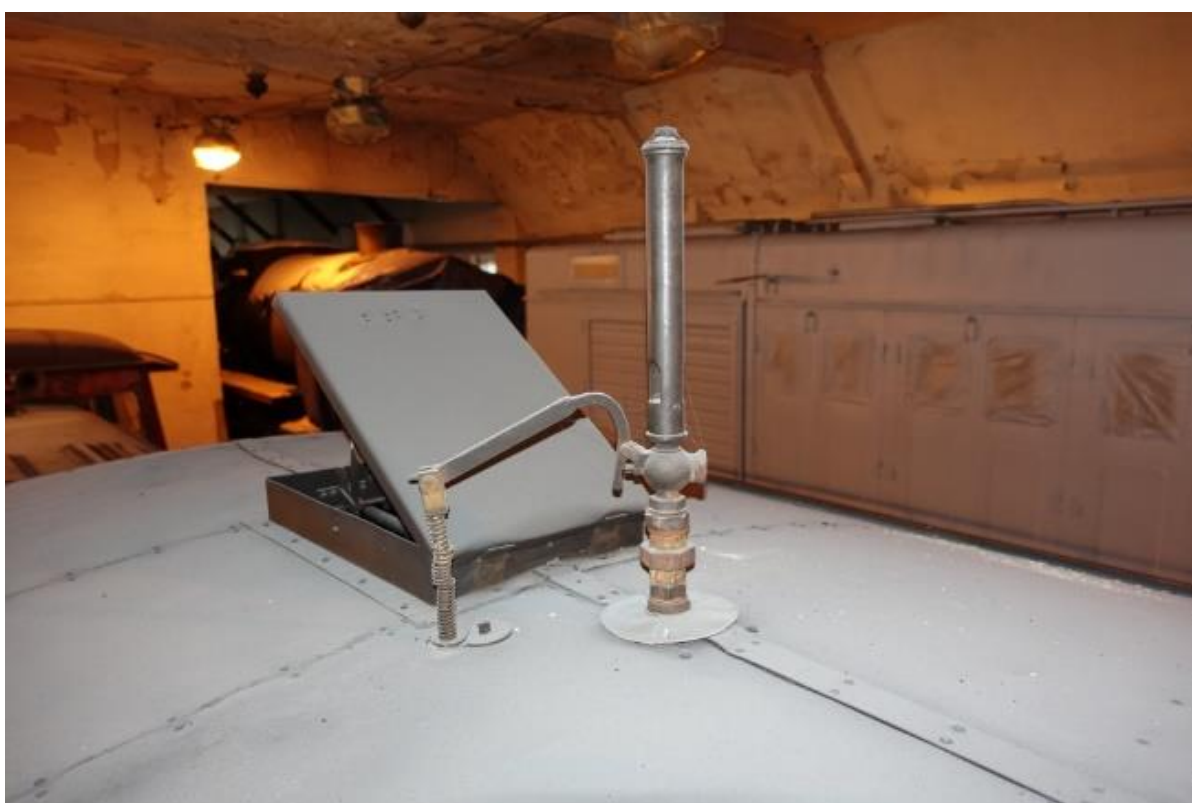
Obr. 7.3. - 35 Prostupy střechou musejí být opatřeny límci proti zatékání vody, tedy řešeny principiálně stejně jako poklop a podtmeleny. Stávající siréna se nahradí obvyklou lokomotivní píšťalou hruškového tvaru.
