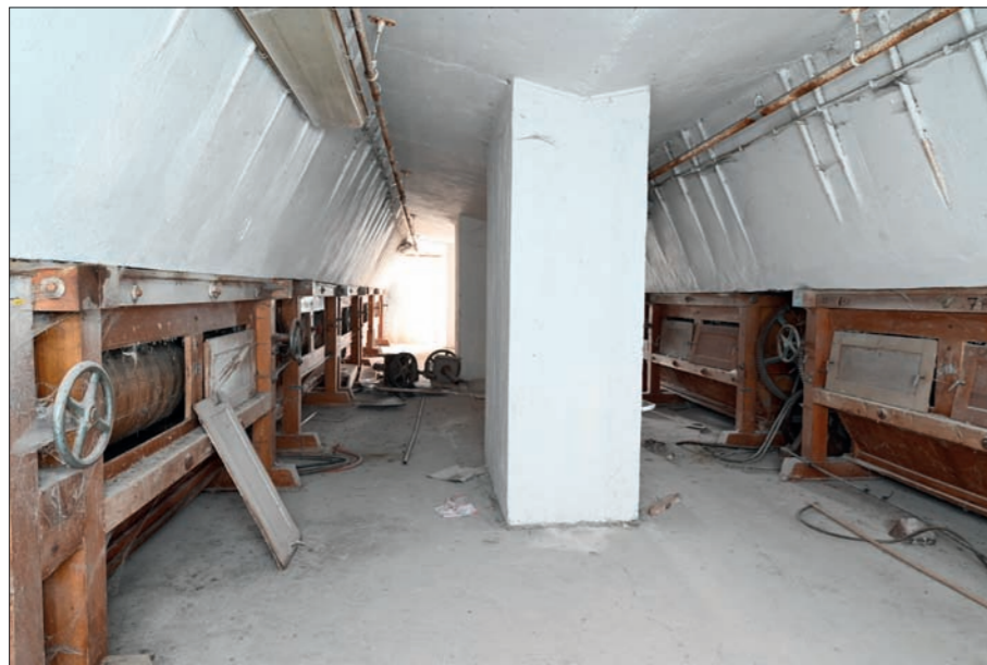
Pohled do střední chodby technologií pro zpracování mouky pro balení
