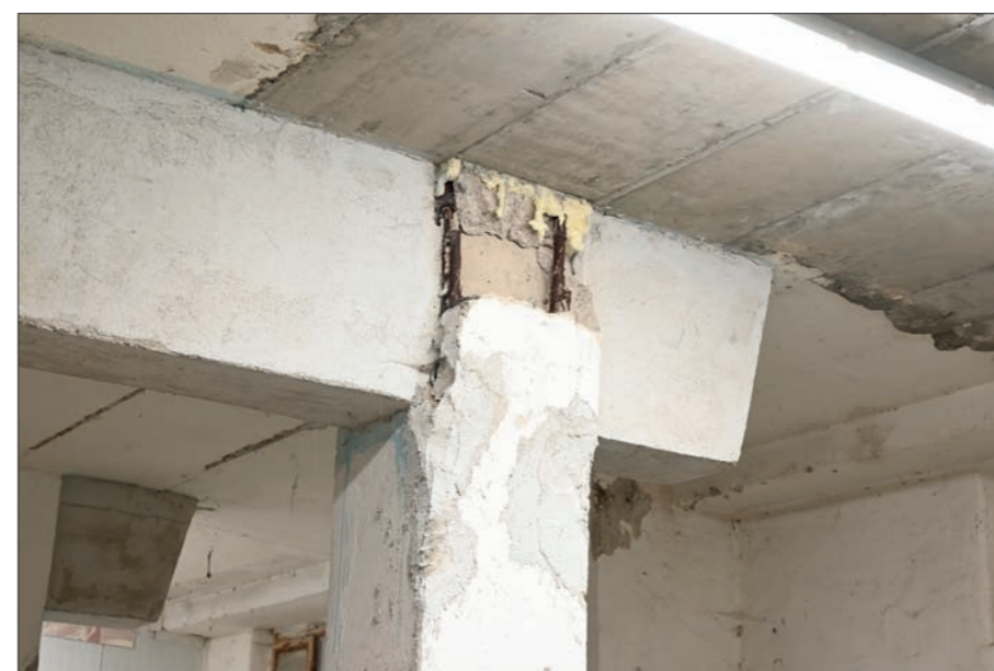
Detail obnažené ocelové výztuže hlavic sloupů
