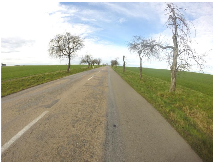
Obr. 25 – Vzrostlá zeleň v bezprostřední blízkosti komunikace v místě odvodňovacího zařízení (příkopu).
