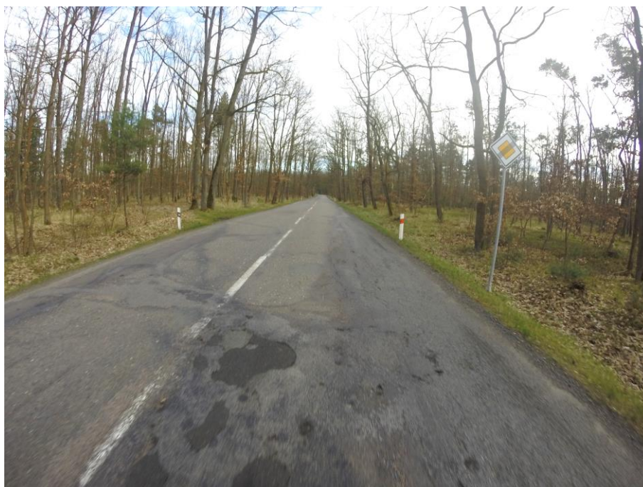
Obr. 22 – Nevhodně umístěná značka č. P 3 v km 0,280.
