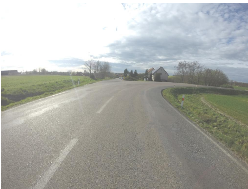
Obr. 8 – Silnice II/323 – extravilán, zatáčka u křižovatky se silnicí III/3231 u obce Vlčí Habřina (km 3,300)
