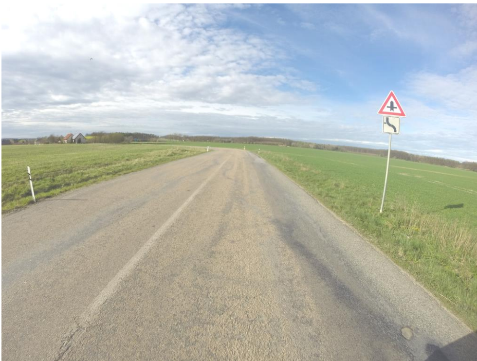
Obr. 7 – Silnice II/323 – extravilán, zatáčka u obce Vlčí Habřina (km 3,100).
