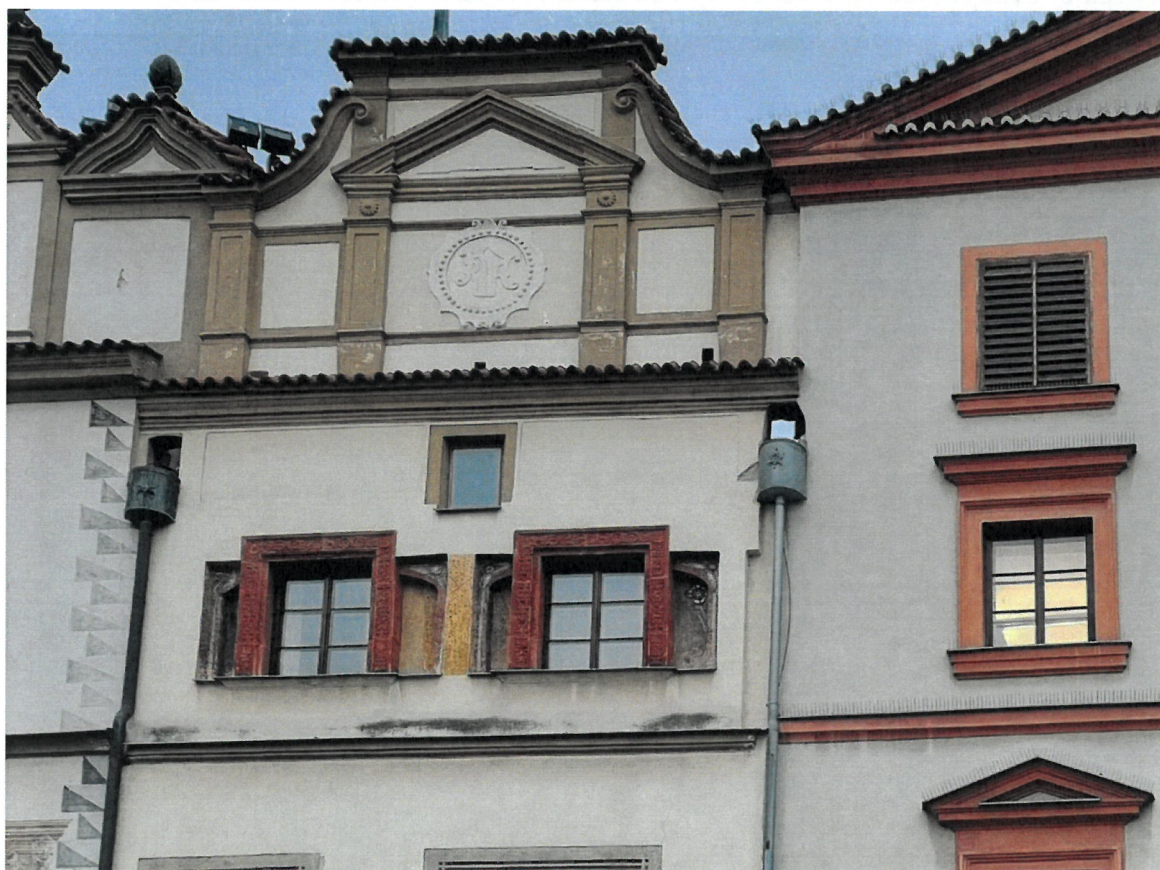
Obrázek 5: Plíseň na fasádní barvě
