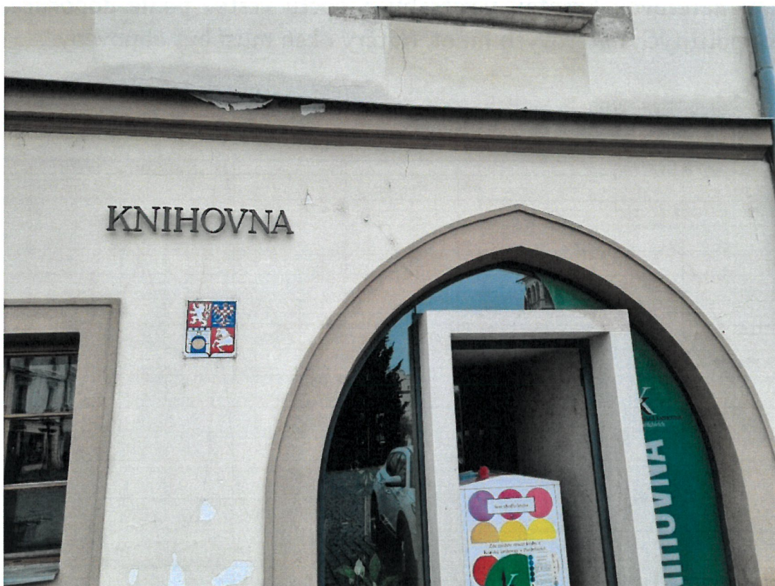
Obrázek 3: Popraskaná fasádní barva, odlupování i se štukem.
