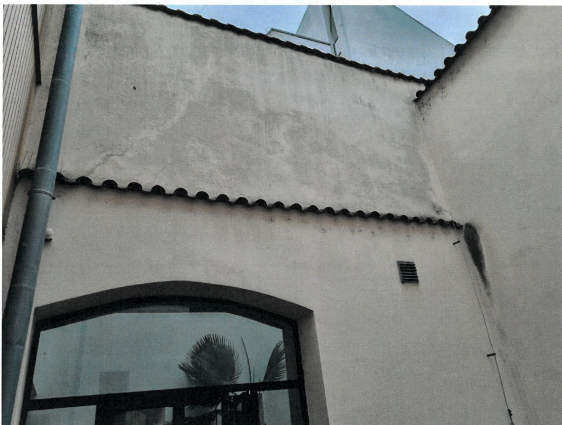
Obrázek 9: Nádvoří I. Plíseň na fasádních nátěrech. Praskliny a degradace fasádních nátěrů.
