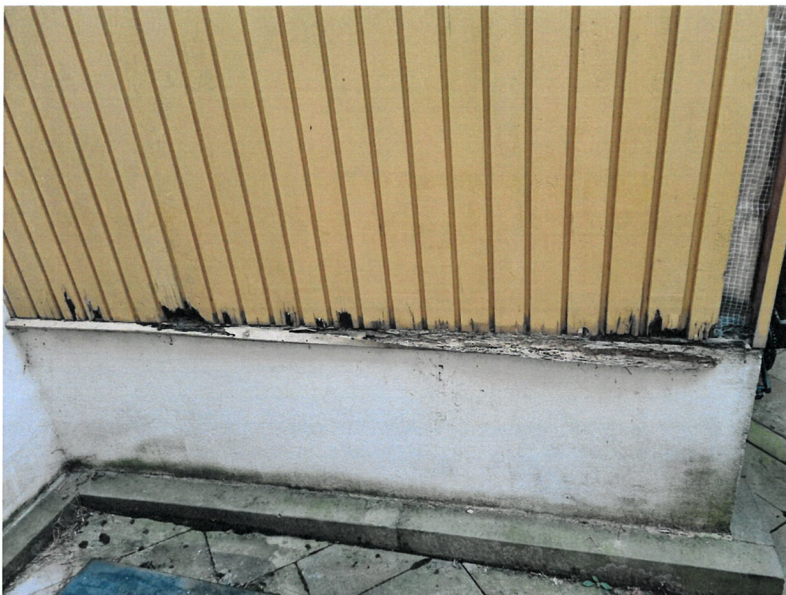
Obrázek 10: Nádvoří I. Degradace dřevěného obložení, řasy na fasádních nátěrech.
