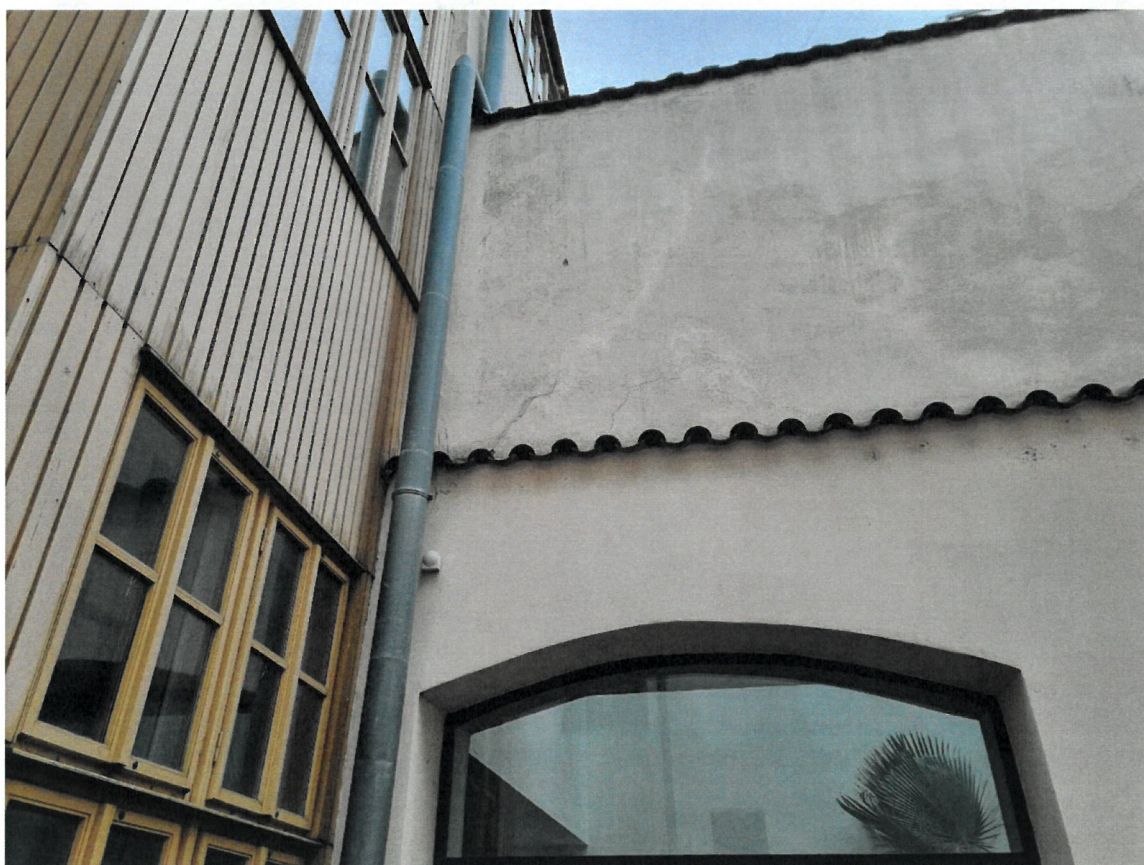
Obrázek 11: Nádvoří I. Degradované nátěry dřevěného obložení.
