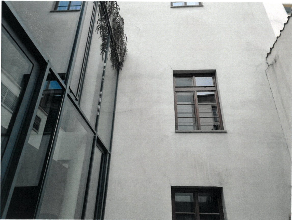
Obrázek 13: Nádvoří II. Popraskané a degradované fasádní nátěry
